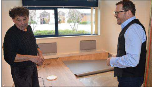
Le directeur du pôle autisme et Ted, Renaud Franchini, supervise les travaux d'installation. Photo L. J.
